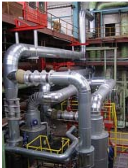
Potrubné prepojenia medzi novými kotlami K4, K5 a technológiou strojovne, včítane turbíny – ilustrační foto
