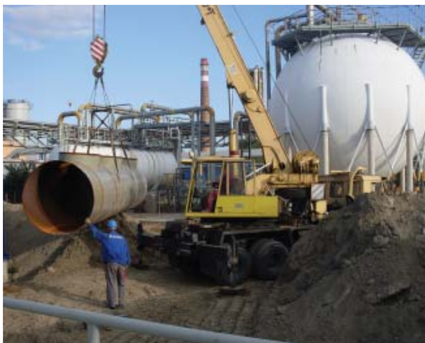
PC4 - potrubie chladiacej vody v objekte strojovne TG5
