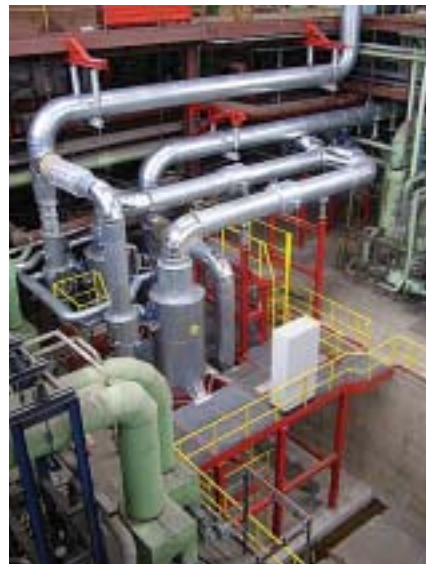
Montáž potrubných rozvodov komplikuje aj fakt, že realizácia diela prebieha za neprerušenej prevádzky a najmä bezprostredne v priestoroch jestvujúcej strojovne - ilustračné foto
